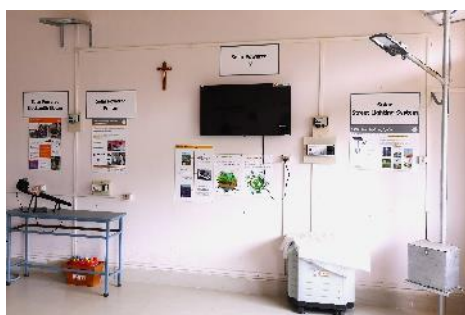
Die Zentren wurden mit moderner Technologie ausgestattet – z.B. solarbetriebenen Lichtern (Nongstoin, 2022).
